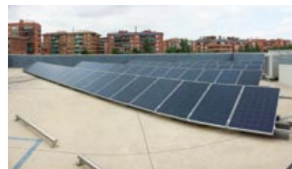
▲ Instalación fotovoltaica de autoconsumo.
